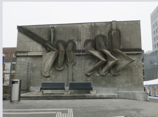
▷ Untersuchung & Schadensanalyse W. Kretz, „Schanzenpost“ [7]
